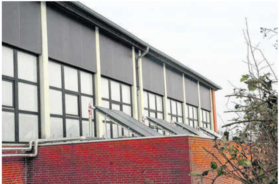
An der Südseite der Turnhalle auf dem St. Georgsberg in Ratzeburg sind die Solarmodule aufgestellt worden. 20 Quadratmeter reichen, um ein Viertel des Energiebedarfs einsparen zu können. <QM>Fotos:<TH>Martin Stein
